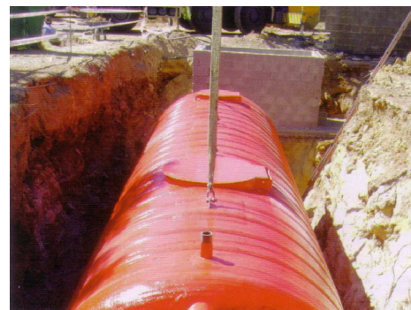
Estación depuradora de oxidación total con decantador
